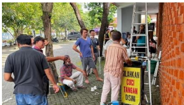
Gambar 6. Instalasi Kran otomatis
