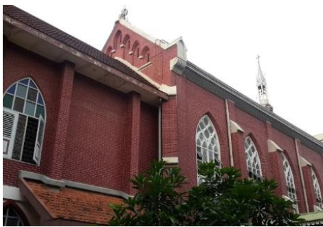
Gambar 2 Batu Bata Klinker Pada Dinding Gereja Katolik Santo Yusup Gedangan ( Sumber : https://pariwisata.semarangkota.go.id )
