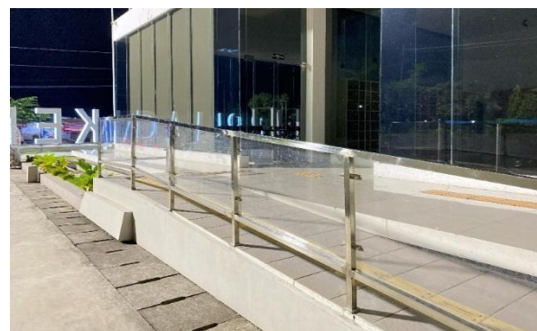
Gambar 4. Kondisi Hand Rails Ramp
