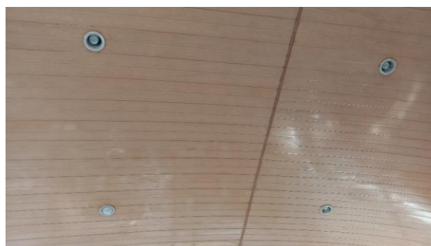
Gambar 18. Lampu Penerangan Sumber : Dokumentasi Pribadi
