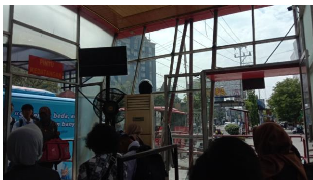
Gambar 9. Fasilitas Pendingin Ruangan Sumber : Dokumentasi Pribadi
