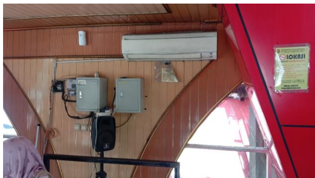
Gambar 8. Fasilitas Pendingin Ruangan dan Pengeras Suara Sumber : Dokumentasi Pribadi
